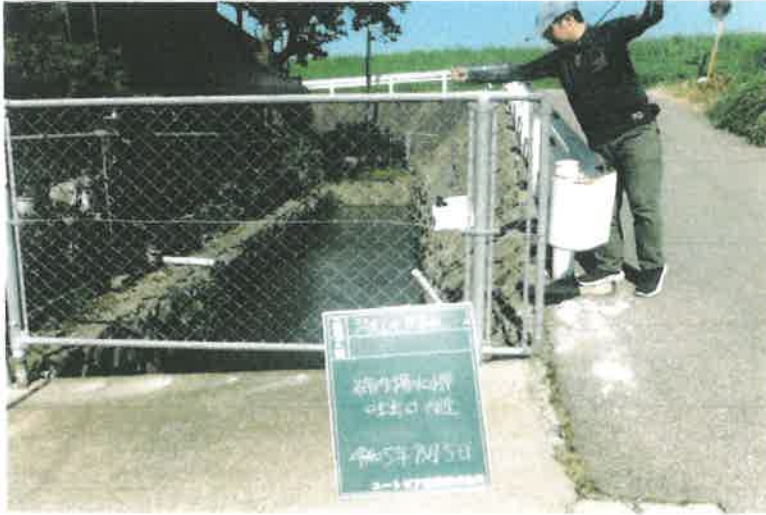
綿内揚水機 吐出し口付近
